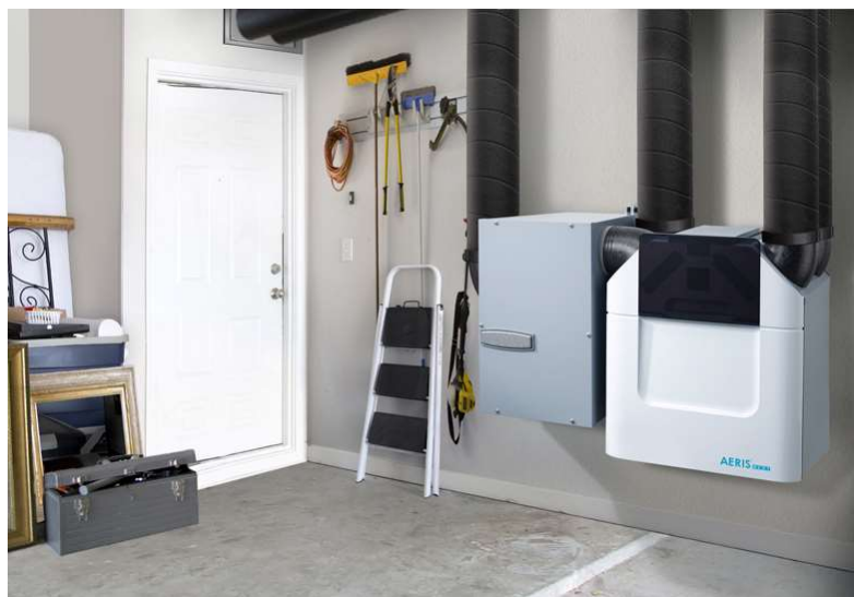
Gruntowy wymiennik ciepła (z lewej) z rekuperatorem AERISnext 350.
