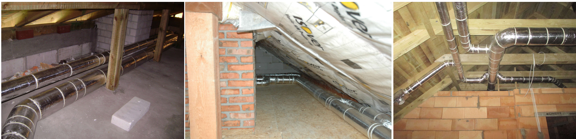
Klasyczna instalacja z zaizolowanych okrągłych kanałów ze stali. 1. Kanały na poddaszu użytkowym przed zabudową w ścianie kolankowej 2. Kanały na poddaszu nieużytkowym prowadzone przy połaci dachu.
