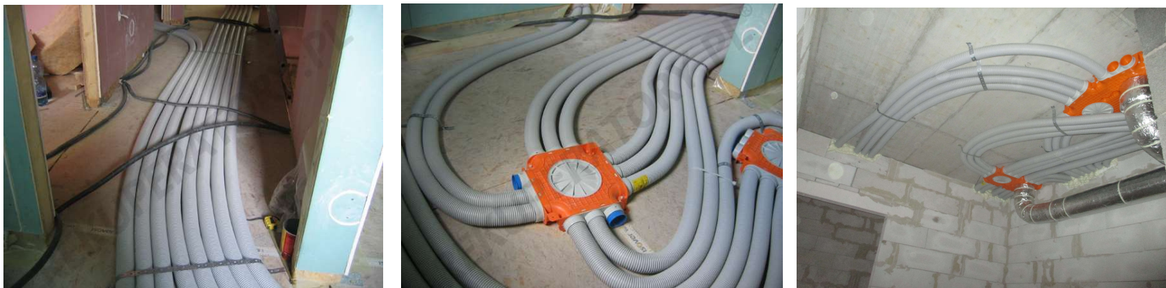
Nowoczesne instalacje rekuperacji z polietylenu o niewielkich średnicach można ukryć w posadzce lub pod sufitem.
